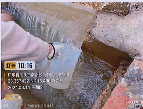
施工 5 标 CYB08#生产废水
